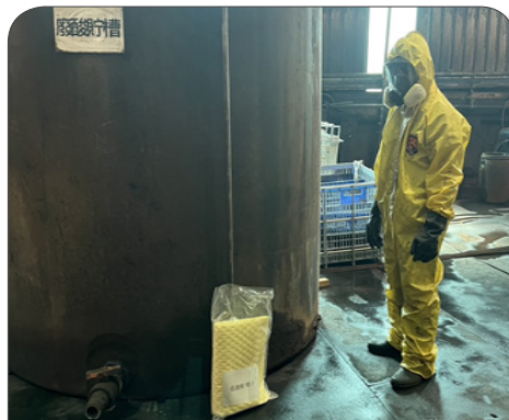
2. 作業員 HCT 酸洗作業時發現廢酸貯槽液體滲漏
